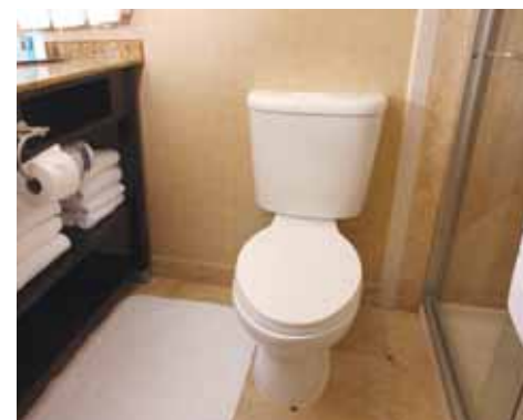
Caroma HET installation at Hilton Palacio del Rio
